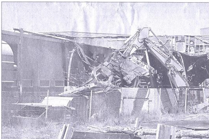
Nach dem verheerenden Brand bei der Firma Schweizer Electronic hat das große Aufräumen begonnen. Foto: Kaiser
